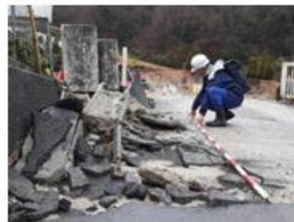
岩屋浄水場の被災（七尾市）
