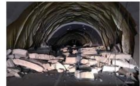
トンネル崩壊（国道249号）
