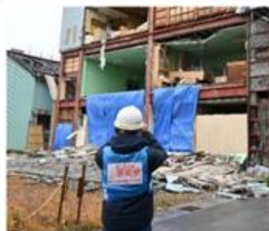
建築物の損壊状況（七尾市）
