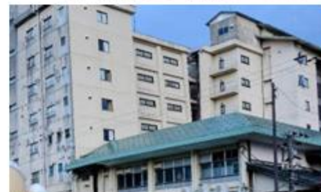
建物損壊（和倉温泉（七尾市））
