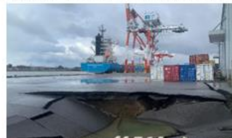
ふ頭用地陥没（金沢港（金沢市））
