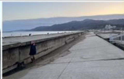
輪島港の被災（輪島市）
