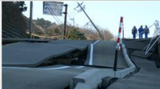
国道249号道の駅千枚田付近（輪島市）
