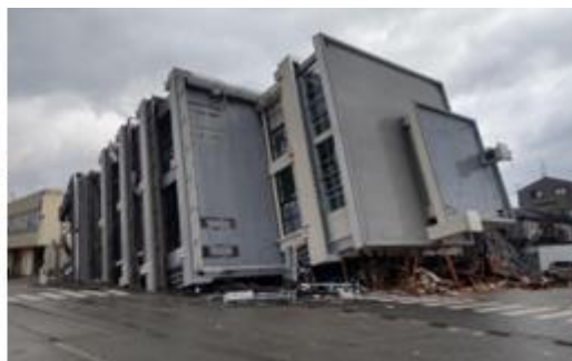
建物倒壊（輪島市河井町地内）
