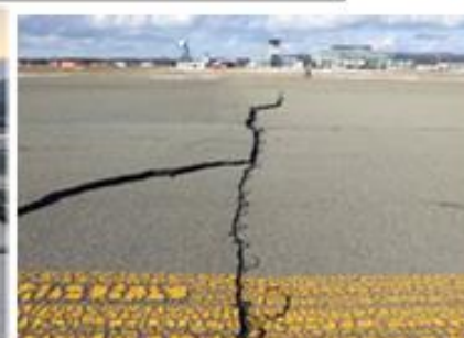
能登空港の被災（穴水町）
