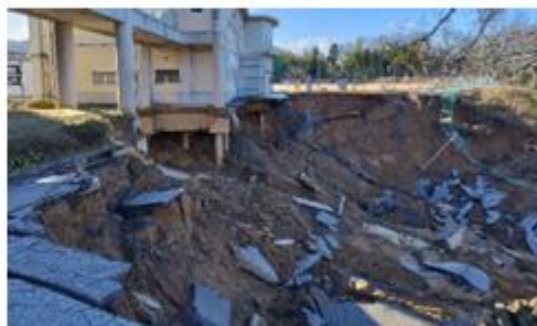
法面崩壊（金沢北陵高校（金沢市））
