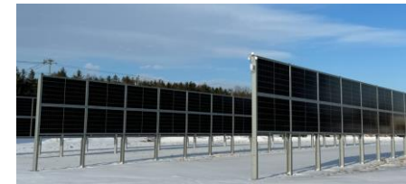
酪農学園大学と自然電力が牧草地に設置した 垂直型太陽光パネル
